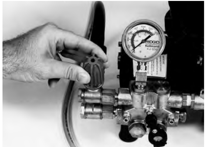
Figura 4 – Regulación de la válvula descargadora
